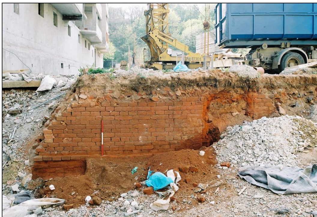
Obr. 2 Řez P1 se zachycenou stěnou západní řady komor v níž je patrný jeden z odtahových otvorů ústících do odtahového kanálu
