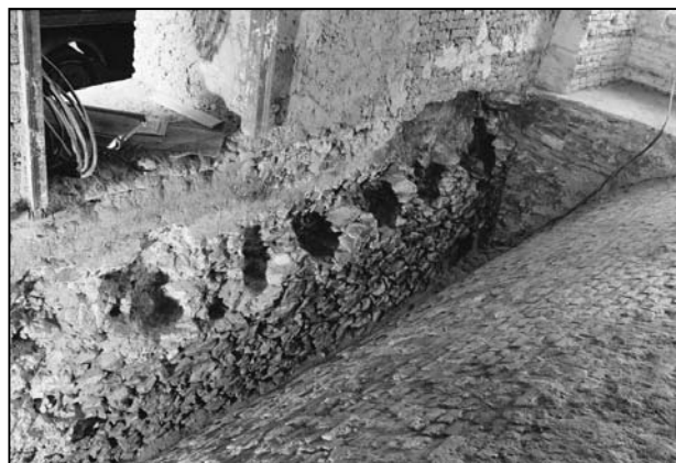
Obr. 3: Brno, Dominikánská 9, pohled z jihovýchodu na korunu západní zdi východního raně gotického sklepa s patrnými trámovými kapsami nad pozdně gotickou klenbou.
