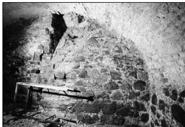
Obr. 8: Brno, Minoritská 2, severní suterén, pohled z jihovýchodu na obvodovou zeď při Jánské ulici s okénkem se strmým bankálem
