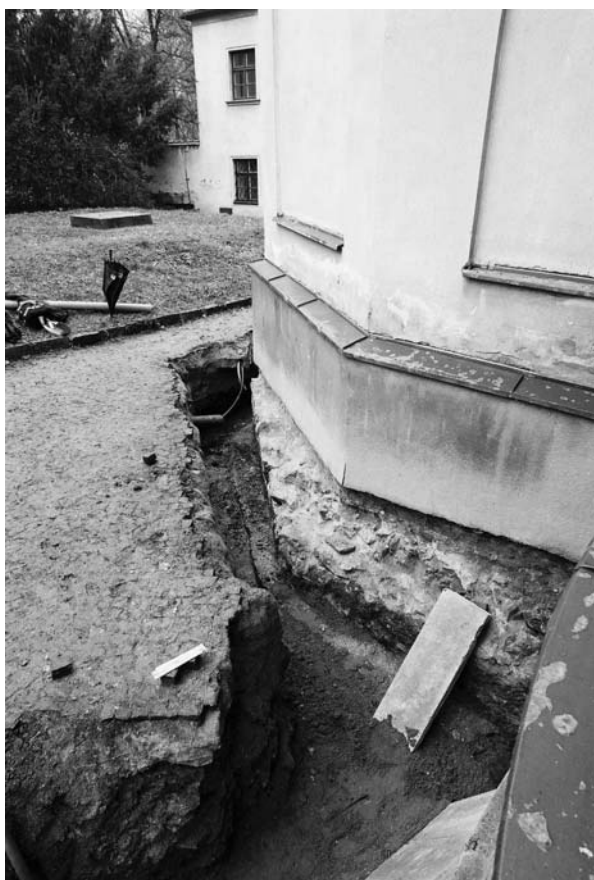
Obr. 55. Ulice Božetěchova, kostel Nejsvětější Trojice (A110/2003). Výkopy pro odvlhčení zdivu kostela. Božetěchova-Straße, Dreifaltigkeitskirche (A110/2003). Aushübe zur Entfeuchtung des Kirchenmauerwerks.
