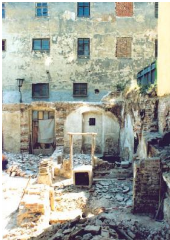
Obr. 20. Františkánská 9 (A224/2000), pohled od severu na demolovanou část domu při uliční čáře. Františkánská Str. 9 (A224/2000), Blick vom Norden auf den demolierten Teil des Hauses bei der Straßenlinie.
