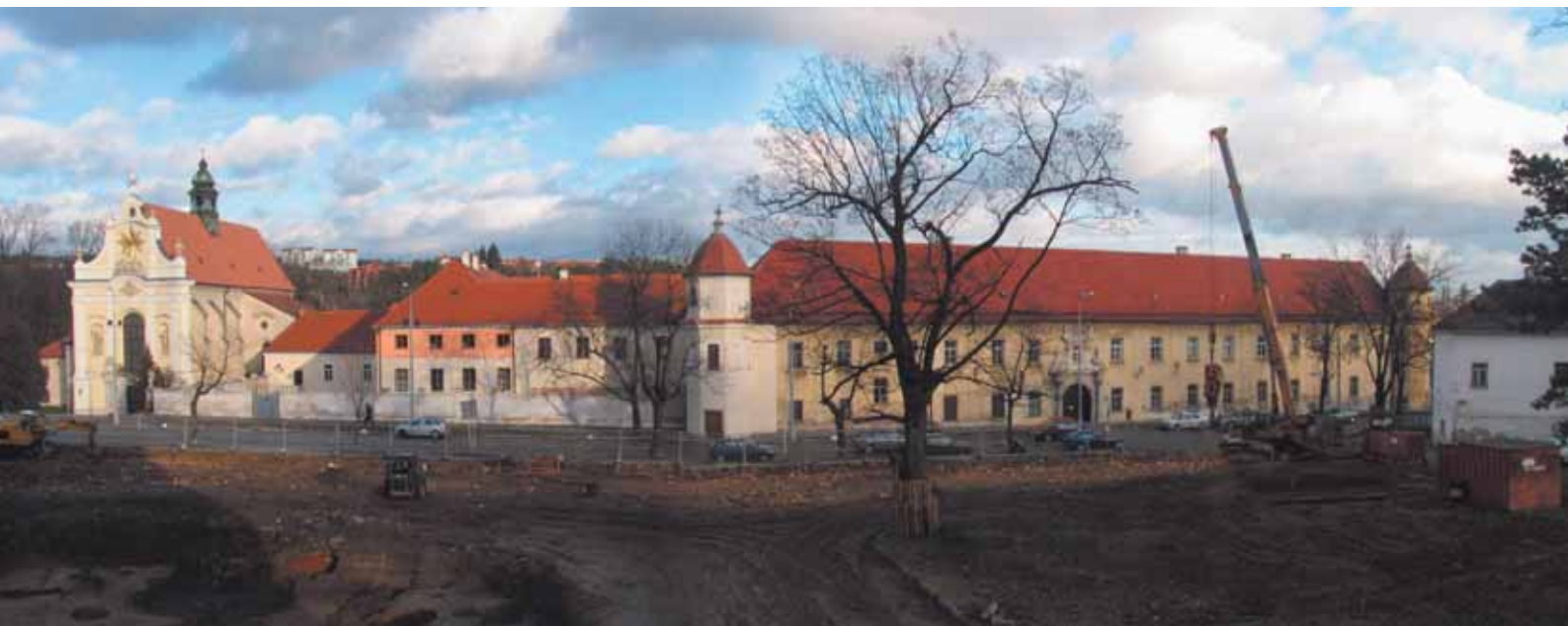
Přípravné stavební práce pro výstavbu nového komplexu otevřely jedinečný čelní pohled na historické budovy kláštera
