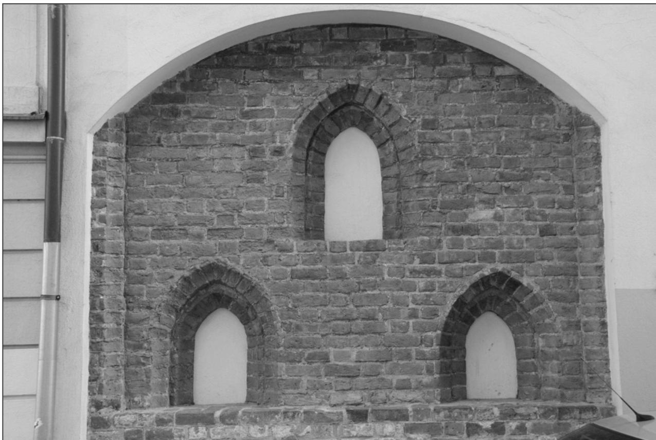
Obr. 22: Brno, Zelný trh 7, zdivo 1. nadzemního podlaží vyzděné z vysokých cihel formátu II.2.
