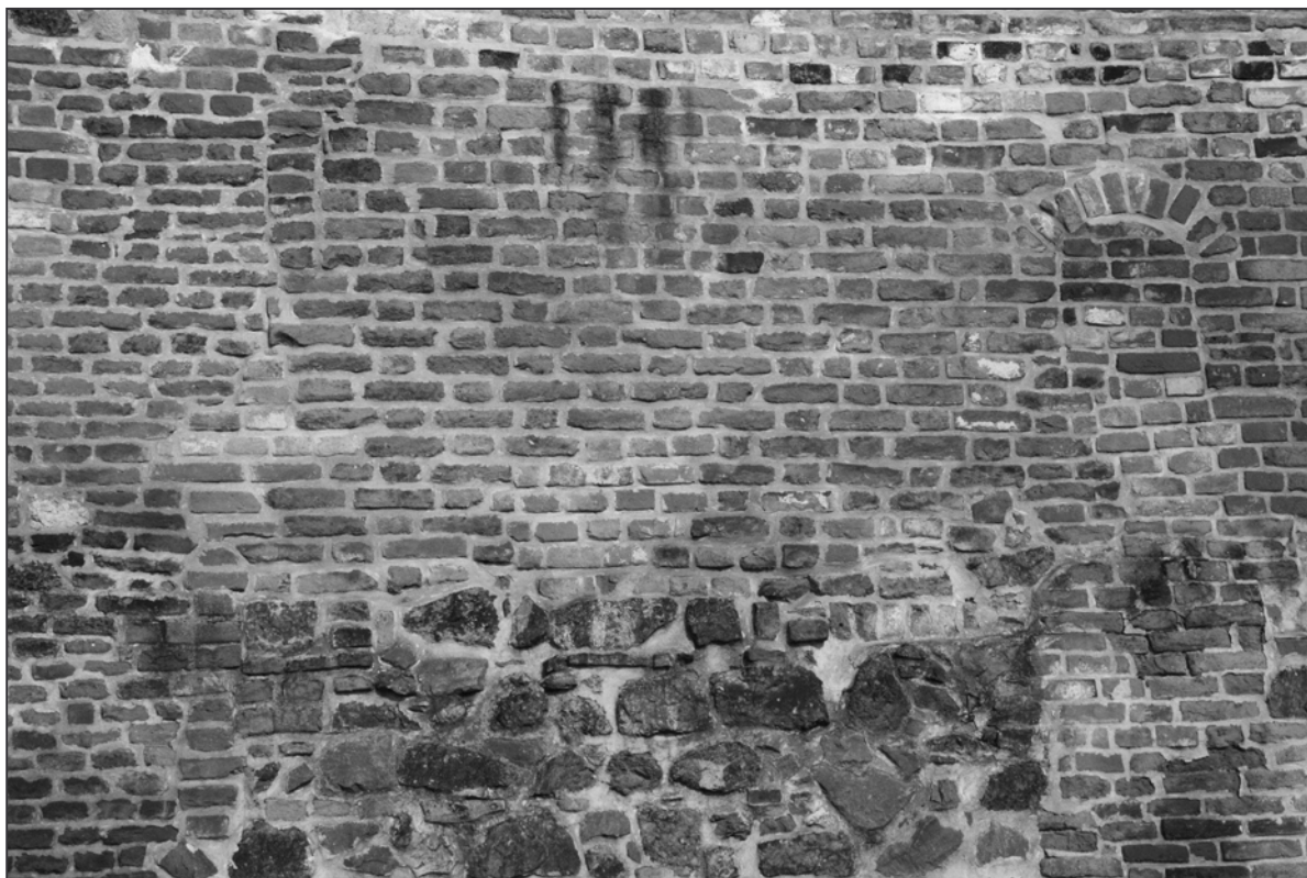
Obr. 28: Brno, Denisovy sady, parkánová hradba s patrnou gotickou vazbou zdíva z cihel formátu II.1.
