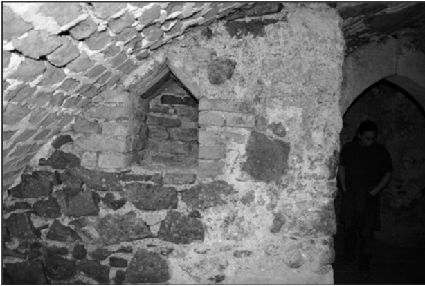
Obr. 12: Brno, Minoritská 2, vyzdění odkládací niky v 1. podzemním podlaží domu z nízkých cihel formátu I.2.
