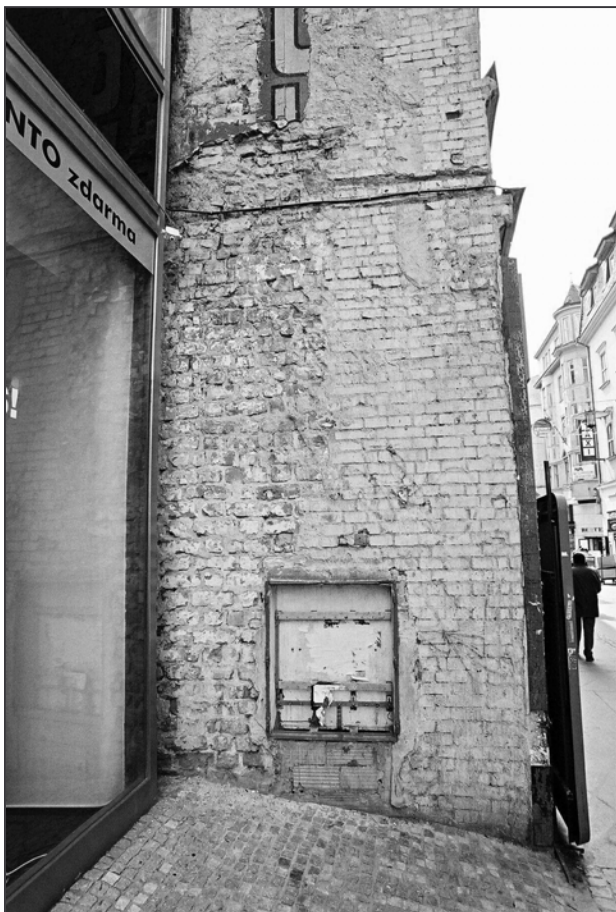
Obr. 23: Brno, Česká 10, vyzdění severní obvodové stěny 1. nadzemního podlaží z vysokých cihel formátu II.2.
